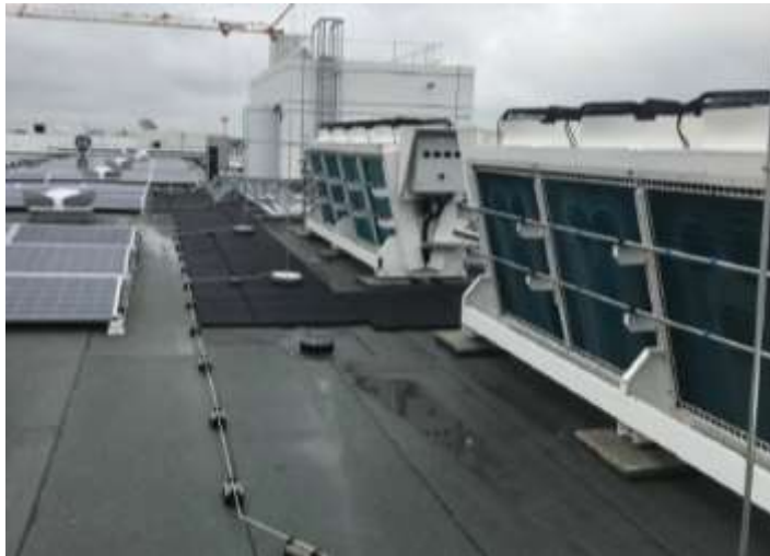
Pilotprojekt – Kälteanlage auf dem Dach. Die erforderliche Zuluft zum Betrieb der Anlage macht eine vollständige Einhausung mittels eines Containers nicht möglich
