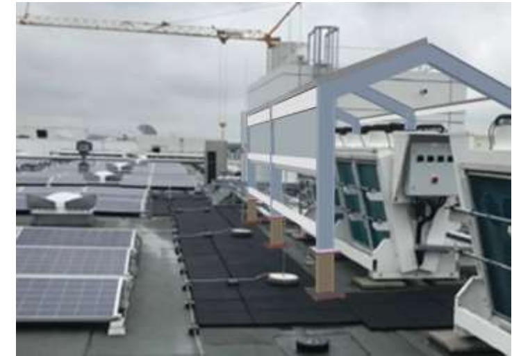
Für die auf dem Dach befindliche Kälteanlage wurde ein Kompromiss aus den anlagentechnischen und den akustischen Anforderungen erarbeitet. Eine offene Einhausung mit partiellen AKUFire-Absorbern war für diese Anwendung die beste Lösung
